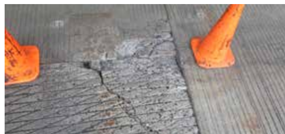
Eine Betonplatte war gerissen und verursachte Probleme auf der Straße.
