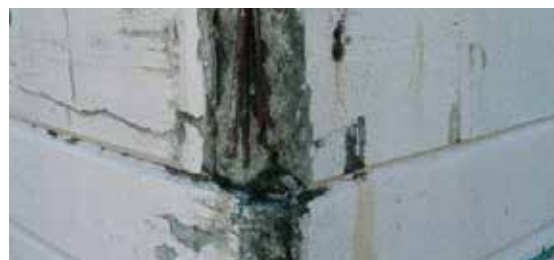
Eine Mauerecke wurde schwer beschädigt.
